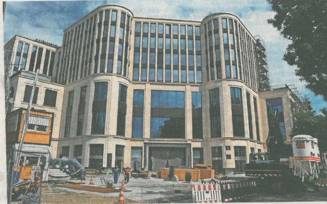
Noch sind die Bauarbeiten am Gerber im Gange – vor allem im Inneren. Aber pünktlich zum 23. September wird das Vorzeigeprojekt an der oberen Königstraße fertig sein. Foto: Ruof
